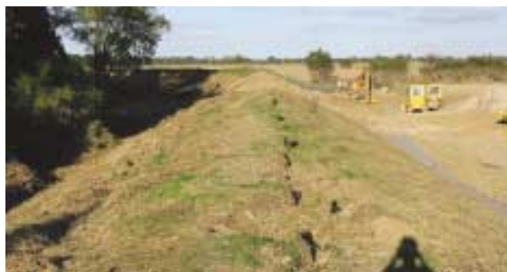
Risse kündigen Rutschungen an und lassen auf eine Schwächung der Standsicherheit schließen.
