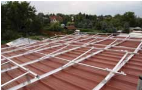
Abb. 16: Durch das Montagegestell sind die Module fest mit dem darunter liegenden Dach verbunden. Die eingesetzten Verbindungstechniken können nicht ohne weiteres entfernt werden, damit sie Schnee und Sturm standhalten. Die Befestigung stellt auch einen wichtigen Teil des Diebstahlschutzes dar.
